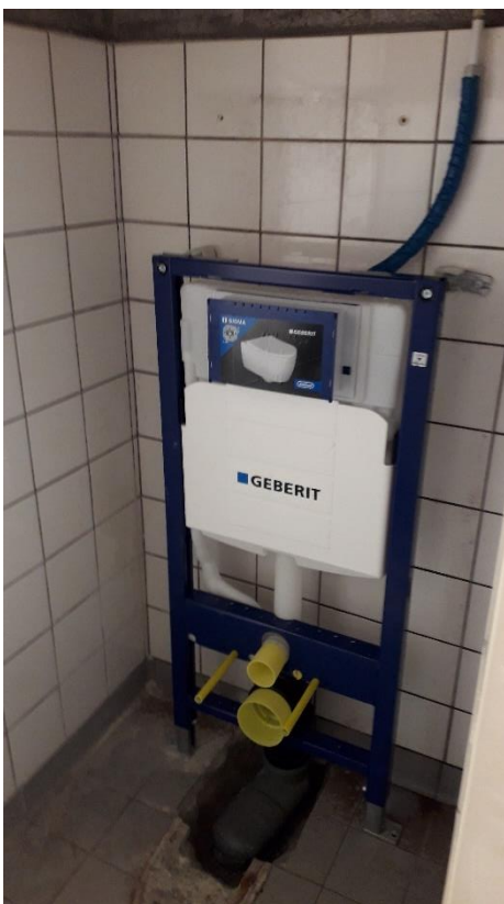
De nieuwe installatie van de wc Daar zie je straks niets meer van, wordt vervolgd.....
